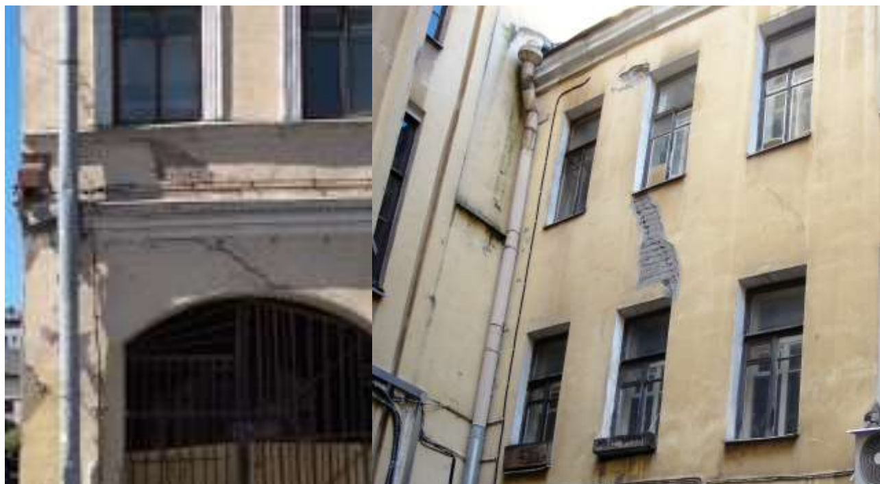
Рис. 5.2. Фото появления и развитие характерных трещин в надземных конструкциях (стен) зданий, вызванных неравномерной осадкой
