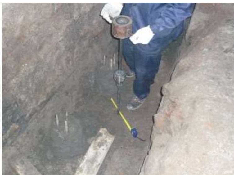
Рис. 5.15. Фото проведения работ, по динамическому зондированию вокруг выполненных выштампованных микро свай усиления основания из подвального помещения
