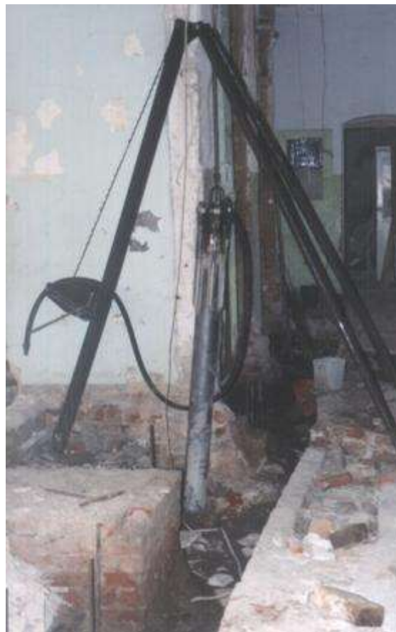
Рис. 5.4. Фотография производства работ по использованию пробойника при выполнении выштампованных микро свай усиления основания
